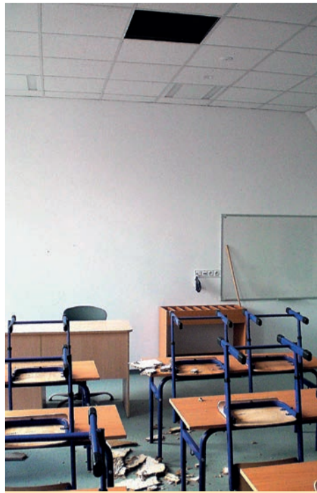
Trzy miesiące po uzyskaniu przez wykonawcę pozwolenia na użytkowanie obiektu, nagle w budynku, którego budowa kosztowała prawie siedem i pół miliona złotych, spadł na podłogę fragment sufitu.
