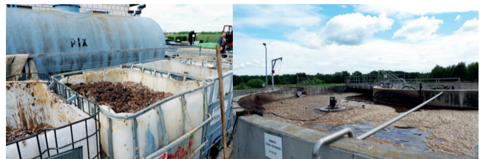
Po usunięciu skratki ścieki przepompowywane są do dwóch reaktorów, w których są napowietrzane i w procesie obróbki biologicznej poddawane ostatecznemu oczyszczeniu.
